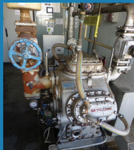
Mycom Ammonia Compressor
